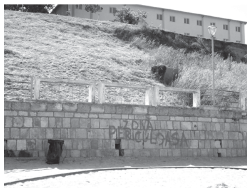
Figura 6. Zona Eforie Sud. Faleza în zona în care lucrările de consolidare executate cu cca. 50 de ani în urmă sunt deteriorate și scoase din serviciu. Între coronamentul zidului de sprijin și partea superioară a falezei se văd fronturile de rupere a taluzului
