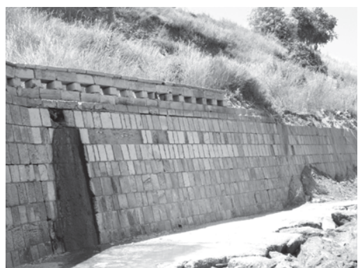
Figura 8. Zona Eforie Nord. Apele din canalizarea orașului, fără să treacă prin stația de epurare, sunt deversate direct în mare, afectând în același timp și stabilitatea falezei
