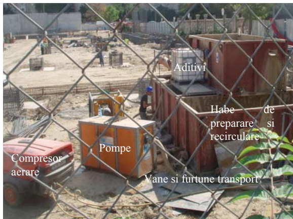
Figura nr. 9. Stația de tratare și recirculare polimeri
