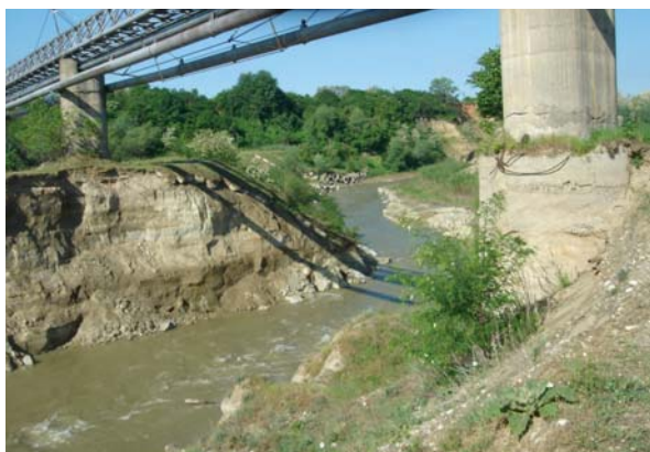
Figura 3. Pila nr. 4 erodată și fisurată
