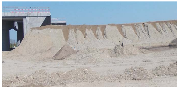
Figura 3. Eroziunea taluzului la rampa de acces pe pod 3, km 28+540
