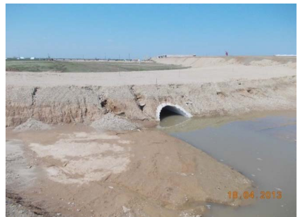
Figura 9. Eroziunea terasamentului în zona de bretea
