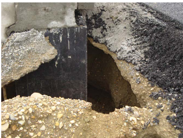
Figura 6. Eroziunea terasamentului sub structura terasamentului la podul 8
