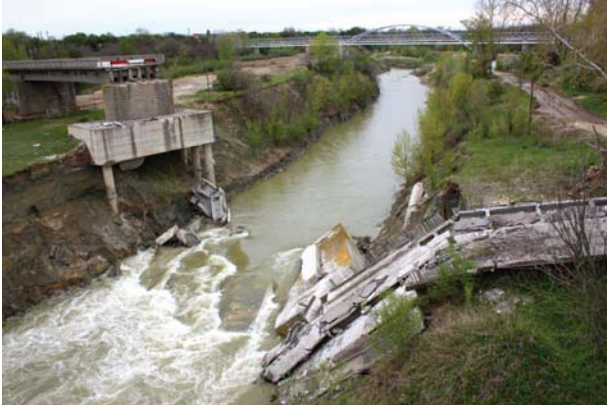
Figura 17. Pod rutier prăbușit în albia râului Argeș
