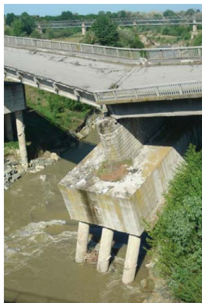
Figura 2. Pila podului prăbușit
