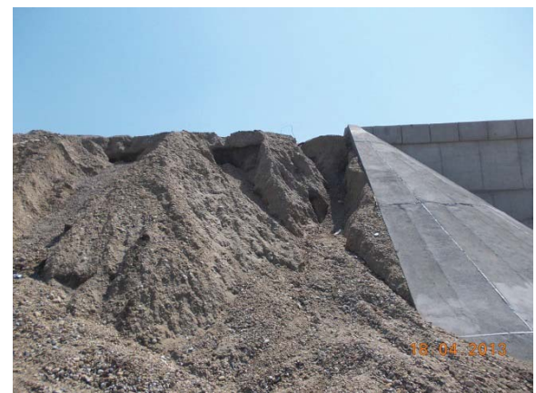
Figura 8. Eroziunea terasamentului la sfertul de con de la podul 9
