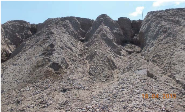
Figura 5. Eroziunea taluzului stânga al rambleului, km 29+930...30+100
