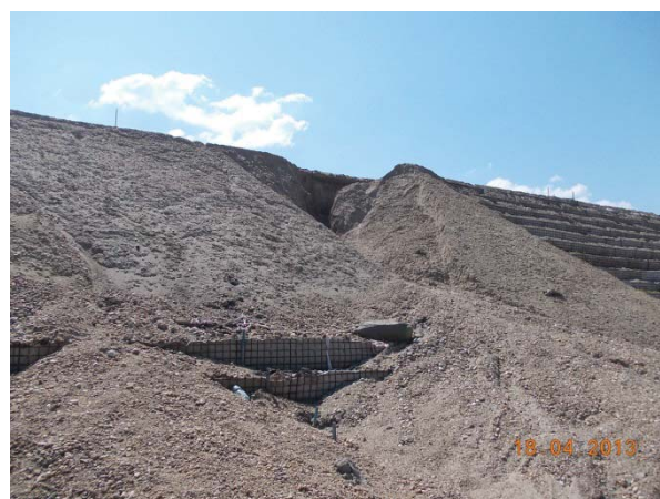
Figura 4. Eroziunea taluzului în zona sfertului de con, km 29+820
