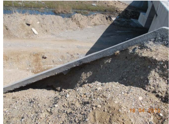
Figura 7. Eroziunea terasamentului sub sfertul de con la podul 8
