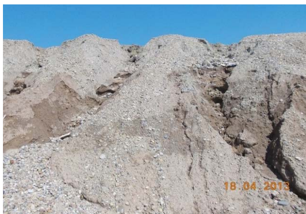
Figura 2. Eroziunea taluzului rambleului, km 28+340
