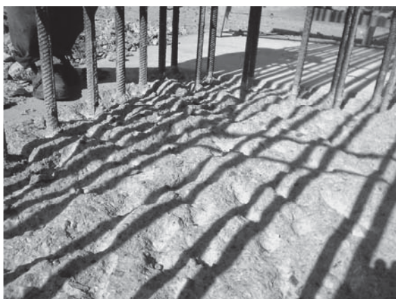
Figura 13. Suprafața de beton buciardată în perimetrul secțiunilor transversale ale stâlpilor
