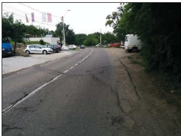
Figura 4 – Degradări ale părții carosabile
