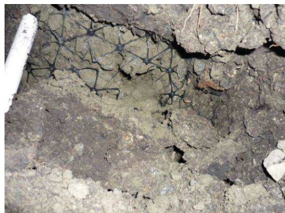
Figura 3. Prăbușirea pământului a relevat ruperea geogrilei
